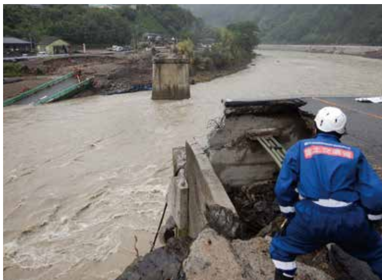
▲国道219号の被災状況調査(熊本県球磨村)
