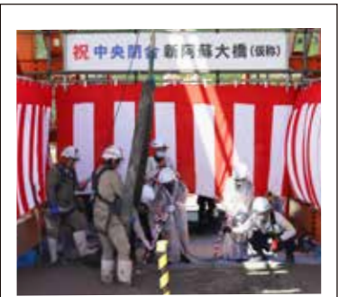
▲新阿蘇大橋中央閉合のコンクリート打ち込み作業に参加した、村内5小学校の代表児童。「一生の思い出」「人の手で橋が作られることに感動」と印象に残ったことを話した。
