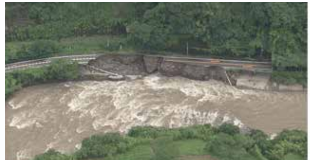
▲令和2年7月豪雨 国道210号日田市赤岩地区被災直後
