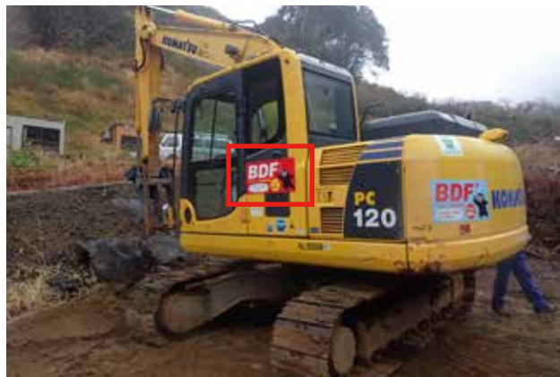
▲バイオディーゼル燃料を使用したバックホーの作業状況
