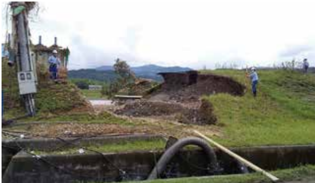
▲令和2年7月豪雨 堤防決壊箇所調査（熊本県人吉市）
